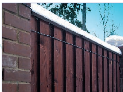
Рис. 11. Сенсорный вибродатчик системы «Дефенсор» на деревянной ограде
