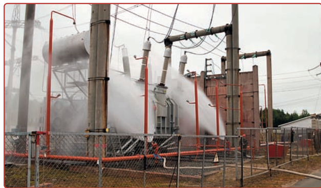
Рис. 6. Водяное пожаротушение маслонаполненных силовых автотрансформаторов с применением лафетных стволов с осцилляторами
