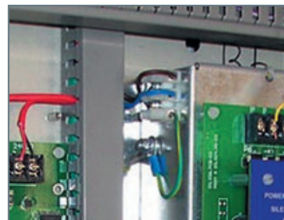
Рис. 5. Подключение заземления к шасси прибора приемно-контрольного
