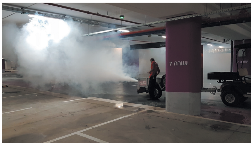
Рис. 1. Работает имитатор дыма, который позволяет проверить фактическое срабатывание пожарной сигнализации и системы контроля и управления дымом
